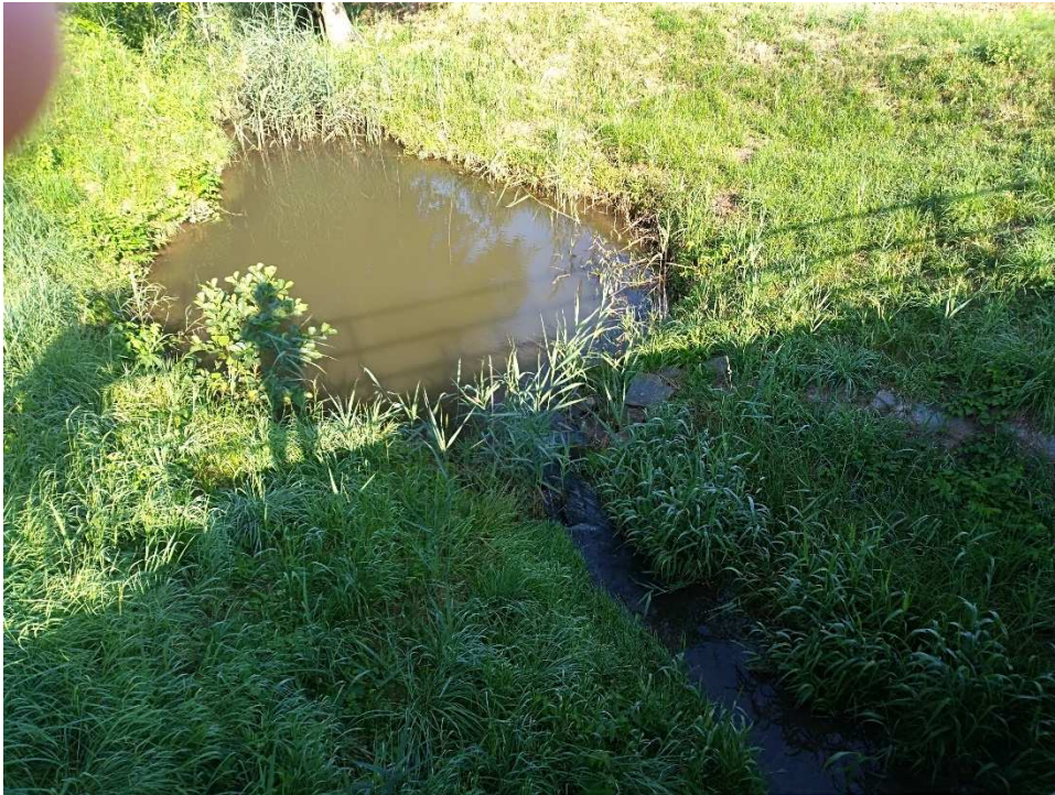
Foto č. 1 – Pohled z mostu u obce Černín nad úh pod stabilizačním stupněm a navazující koryto zarostlé makrovegetací
