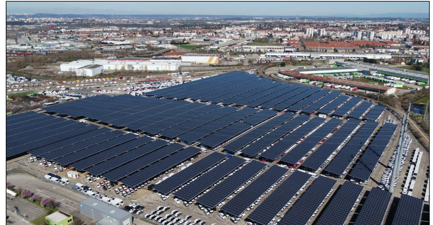
Obrázek 38: Parkoviště zastřešené fotovoltaickými panely (instalovaný výkon 16,3 MW na ploše 12,5 ha), Francie, Corbas (Zdroj: Neoen)
